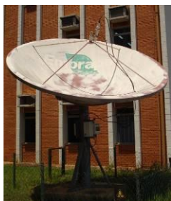
Antenas receptoras de sinais.
